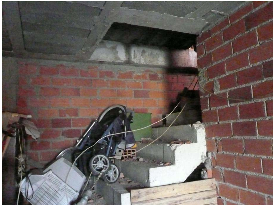
Foto 6 – Interno da vivenda nº8. Xuño 2010. A familia, con catro fillos pequenos continúa habitando a vivenda a medio construír desde que se paralizou a intervención municipal a finais do ano 2007, co oco da escaleira no teito aberto cara o exterior.
